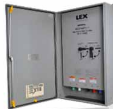
Panel Entrada con Interruptor Manual de Emergencia
